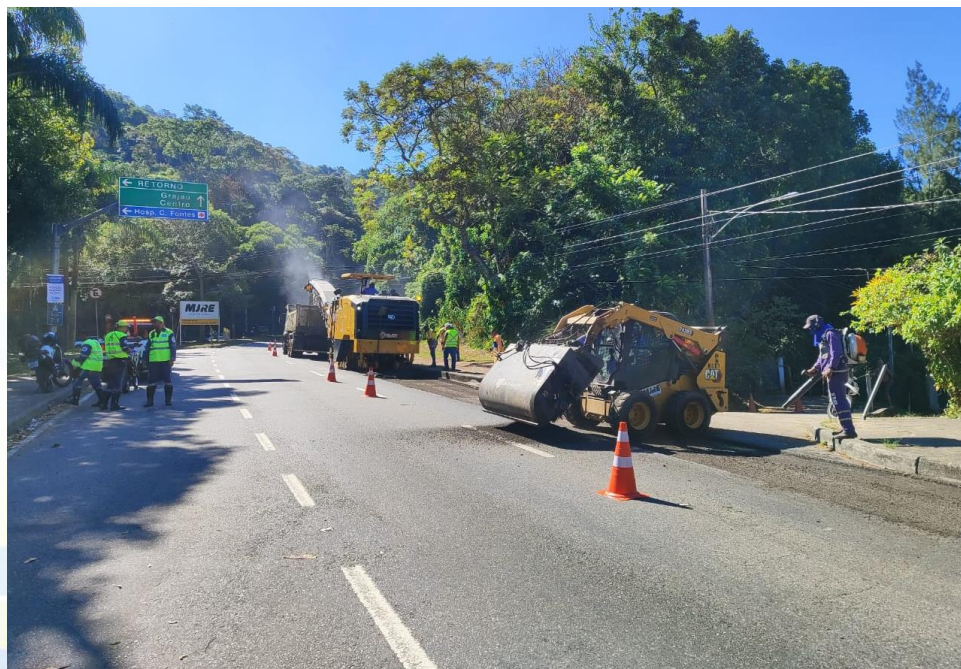
Aplicação de microrrevestimento asfáltico para aumentar a aderência nos trechos curvos da Av. Menezes Cortes
