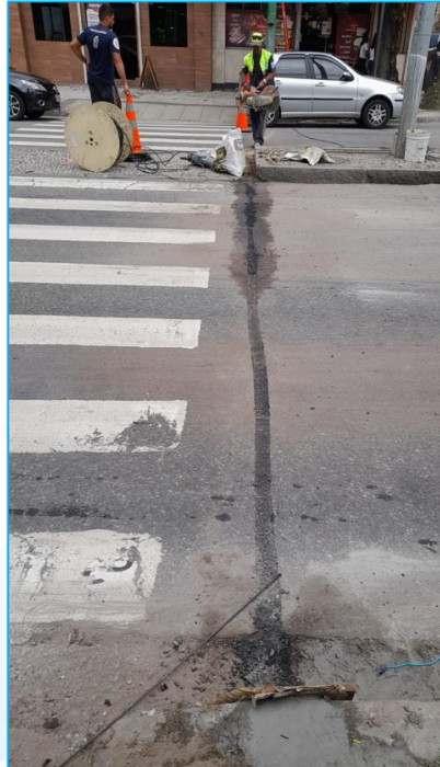
Cabos enterrados no solo
