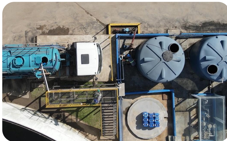
Reuso da ETE Deodoro
